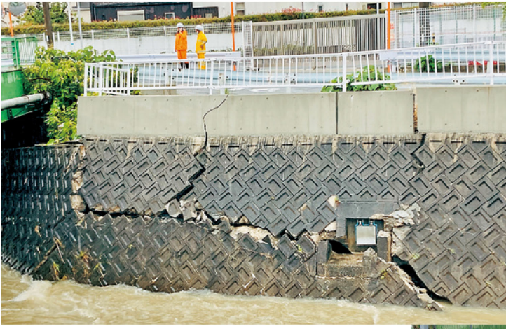
観音橋西側の崩れた護岸
