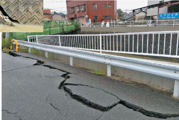
亀裂が生じた路肩
